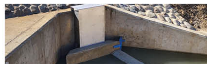
COLOCACIÓN DE LOS SENSORES DE CALIDAD
