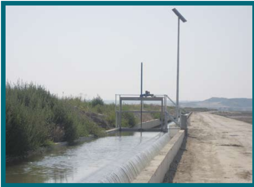
Figura 5. La utilización de elementos de alta eficiencia energética permite controlar instalaciones de gran envergadura alimentando el sistema a través de paneles solares de reducidas dimensiones.
